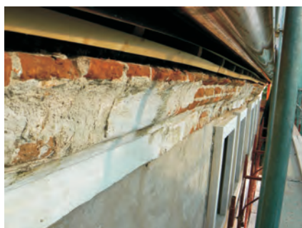
cornice sottogronda ammalorata da rivestire
